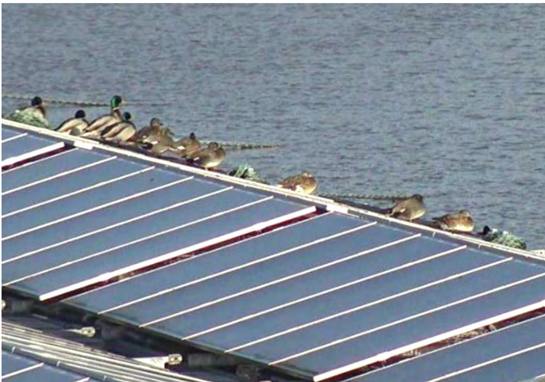
Abb. 13: Ruhende Enten auf einer PV-Anlage (Quelle: ROYAL HASKONING DHV 2022)
