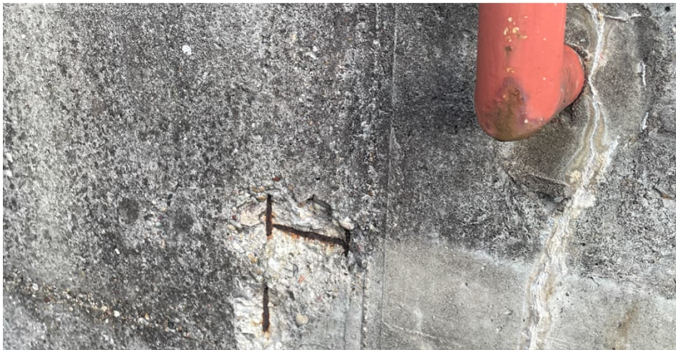
freiliegende Bewehrung/zu geringe Betondeckung
