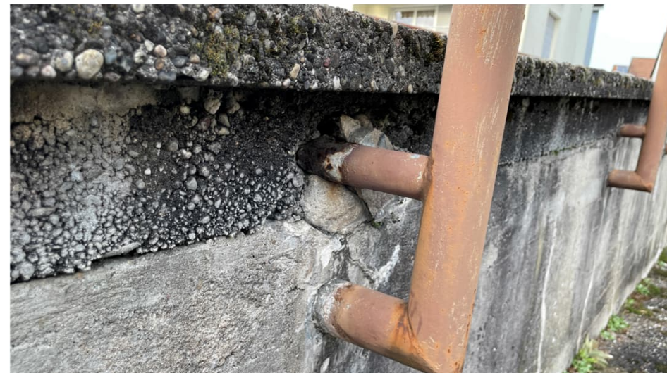
Korrosion Geländer, mangelhafte Verankerung
